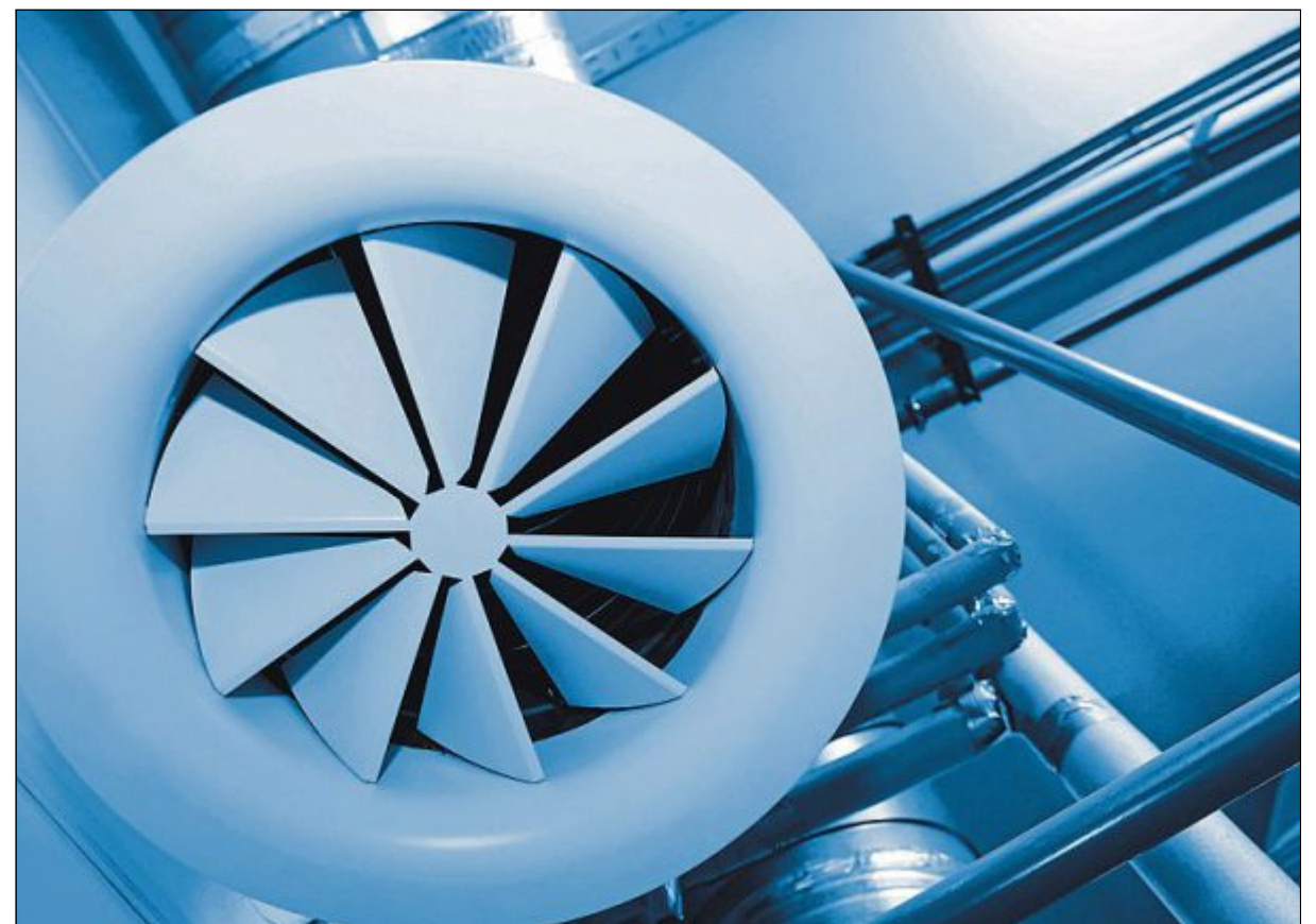
Der Ventilator/Propeller einer Lüftungsanlage.
